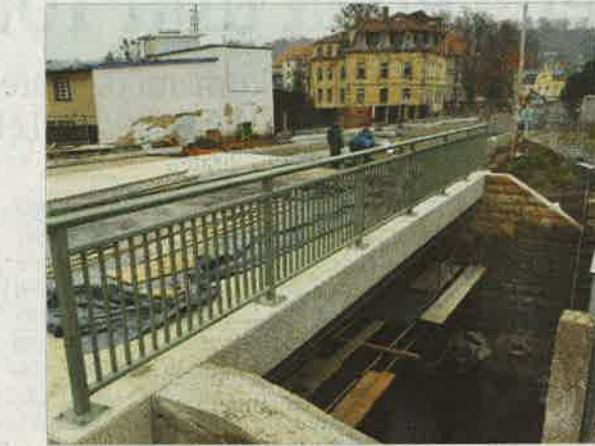
Die Gottleubabrücke ist fast fertig. Leider fehlt noch etwas Wichtiges: Der Asphalt. Archivfoto: D. Spittel
