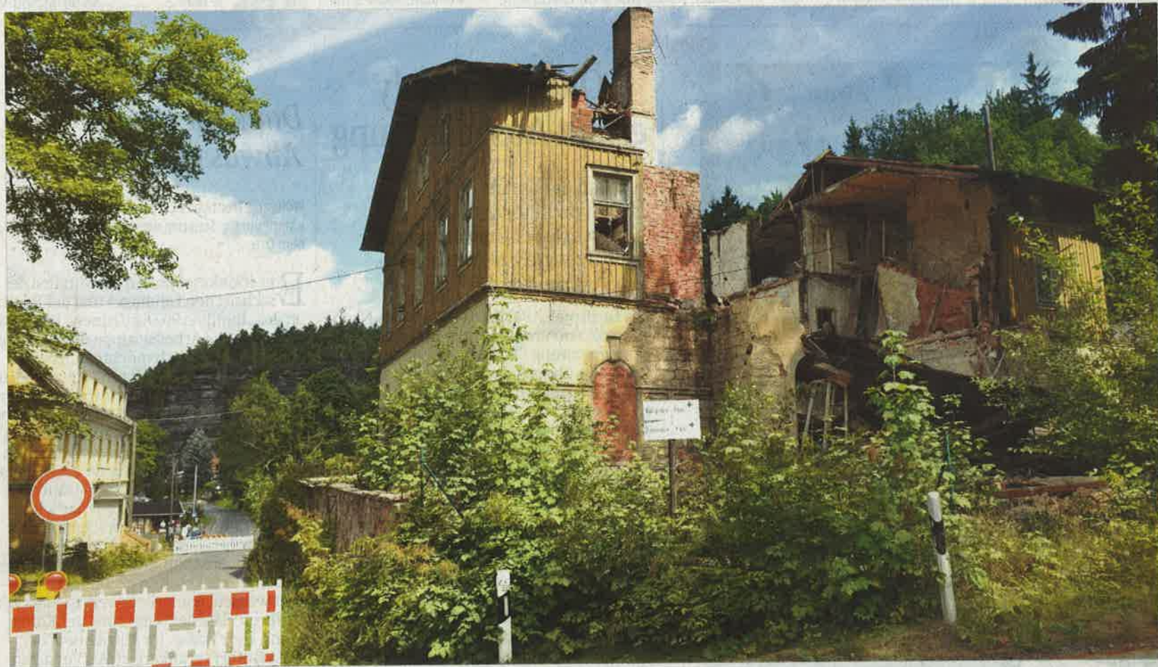
Trauriges Ende: Ein Gebäude der traditionsreichen Schweizermühle in Rosenthal stürzte gestern teilweise ein. Weil der Rest des Hauses auf die Straße zu fallen droht, wurde sie gesperrt.
